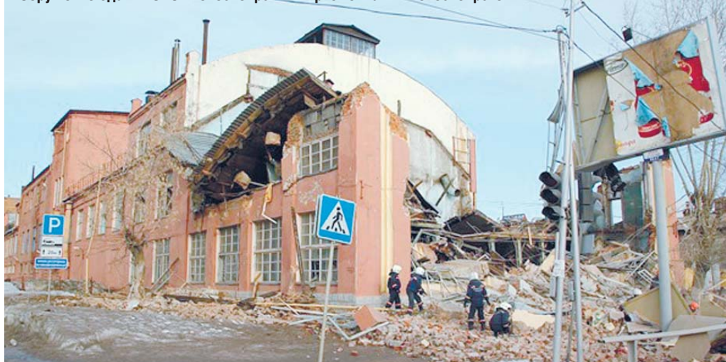
Обрушение здания ОАО «Новосибирский жиркомбинат» в Новосибирске
