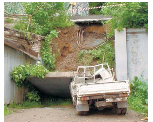
Обрушение подпорной стенки на улице Светланской во Владивостоке
