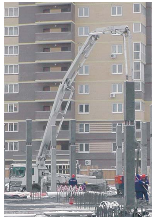
Укладка бетонных смесей в зимний период при строительстве жилого дома по ул. Бр. Кашириных
